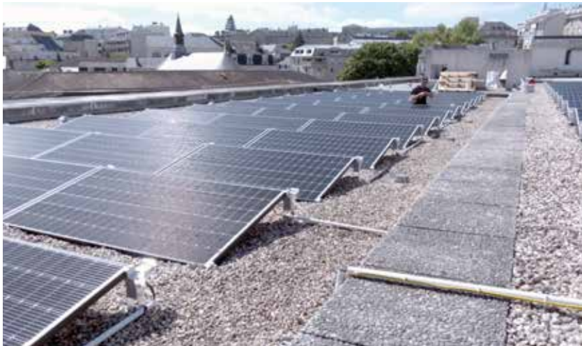
Le toit de la Bfm, équipé de panneaux photovoltaïques.
