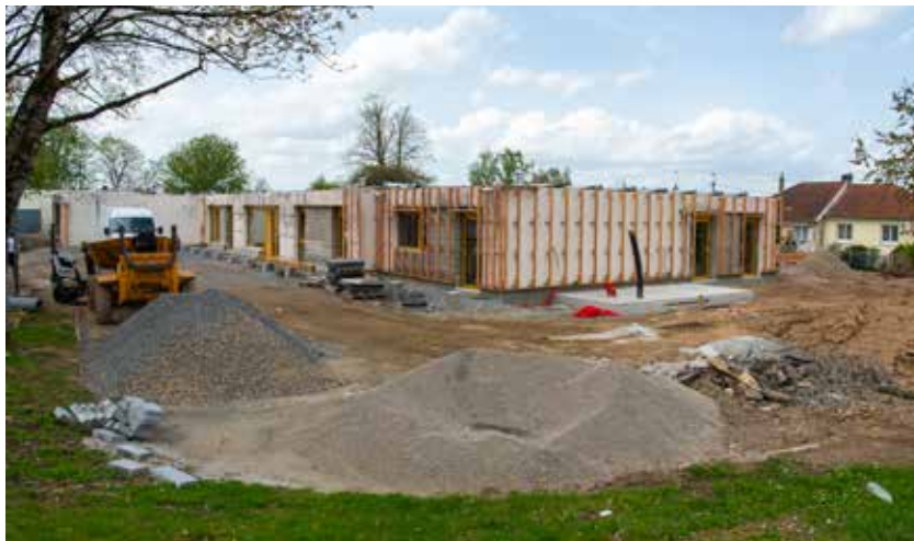
Les travaux se poursuivent à côté de l'antenne mairie Limoges sud Romanet le futur espace mutualisé Robert-Hébras accueillera bientôt les enfants, les seniors et les associations du quartier.
