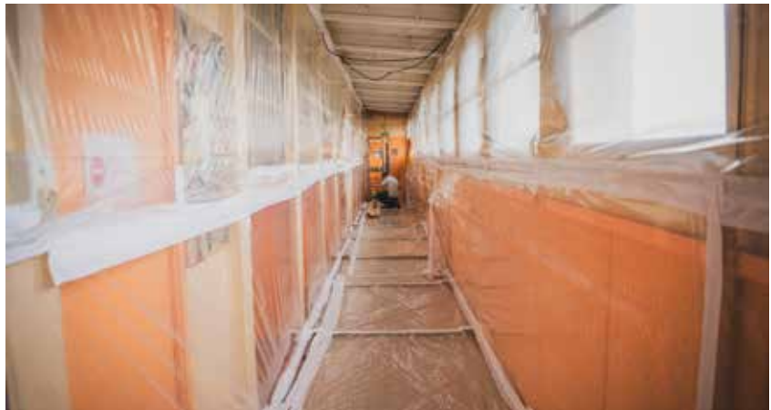
Les travaux sont en cours à l'école du Vignal suite aux intempéries survenues le 17 septembre 2023. Cette année, les classes impactées sont accueillies dans les locaux de l'école Descartes, située à proximité.
